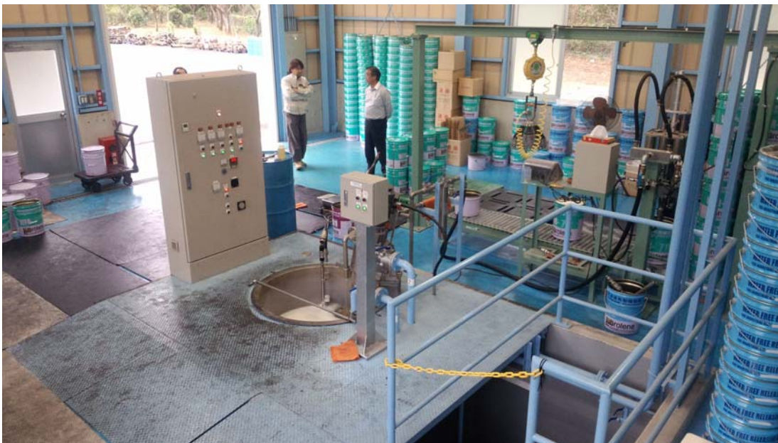
当社が 2012 年に納入した埼玉県・美里工場の設備
